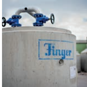
Pumpenschacht DN1200 mit eingebauter Doppelpumpenanlage
