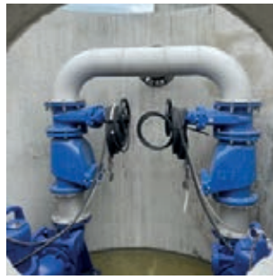
Pumpstation im Rundbehälter
