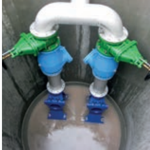
Pumpenschacht DN1200 mit Doppelpumpenanlage, Absperrschieber und Rückstauklappe
