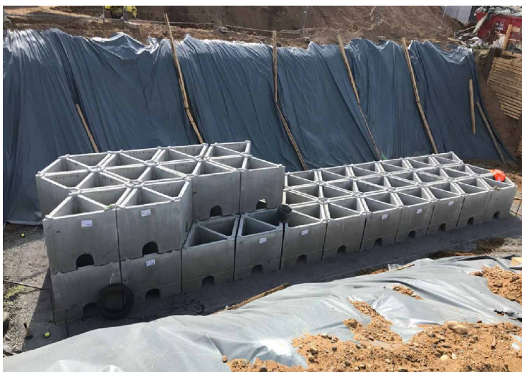
Versickerungsanlage mit Versickerungsmodul „Perco“.
