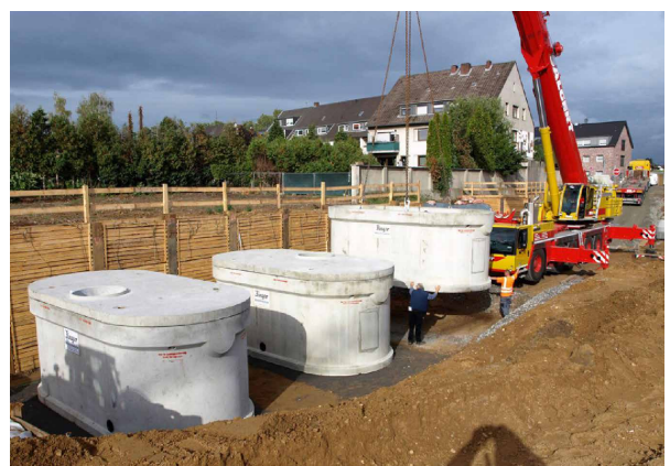
Zwischenspeicher mit einem Gesamtvolumen von 75 m 3 .
