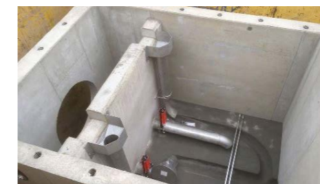
Ein Drosselbauwerk sorgt dafür, dass das im Rückhaltekanal angestaute Wasser nur verzögert in den Ablauf mit kleinerem Querschnitt abgegeben wird.
