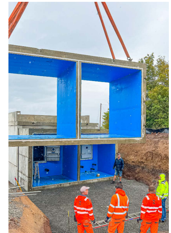
Die Elemente, aus denen sich der Trinkwasserspeicher zusammensetzt, sind perfekt aufeinander abgestimmt, um die Anlage mit der erforderlichen Dichtigkeit zu betreiben.
