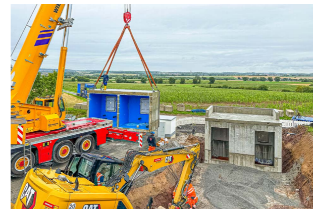
Die Trinkwasserspeicher bestehen aus zwei Kammern und sind mit PEHD ausgekleidet.
