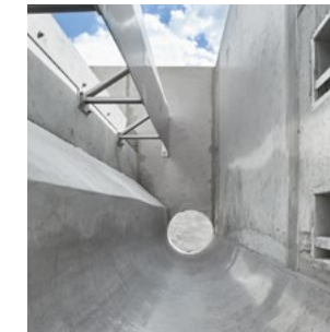
Bauwerk mit Edelstahleinbauten (Tauchwand, Schwelle, Steigkästen in der Wand)
