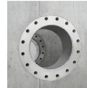
FF-Stück aus Edelstahl in Wand bündig eingebaut
